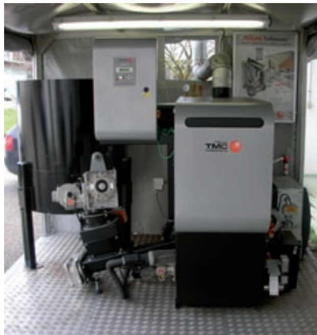
Figura 6.3: esempi di caldaie certificate per la combustione del miscanto, con sistema a griglia vibrante (Froling) ed a griglia ribaltabile (ETA).
