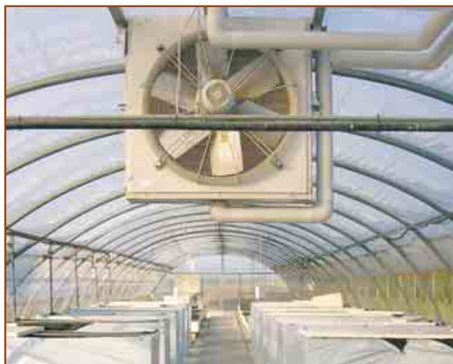
Foto 18. Serra-tunnel riscaldata dalla caldaia a cippato
