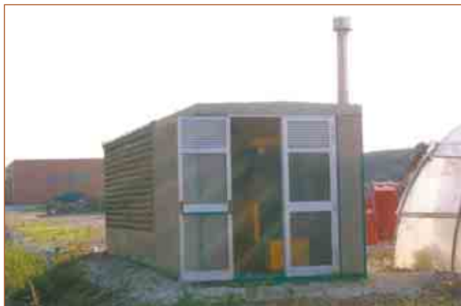
Foto 12. Impianto termico installato nel Centro di Po di Tramontana
