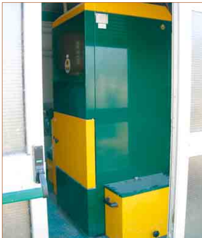
Foto 13. Caldaia a cippato della potenza di 80 KW
