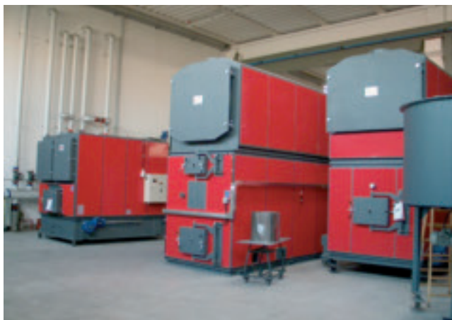
Foto 4.2. Grandi caldaie per teleriscaldamento.
