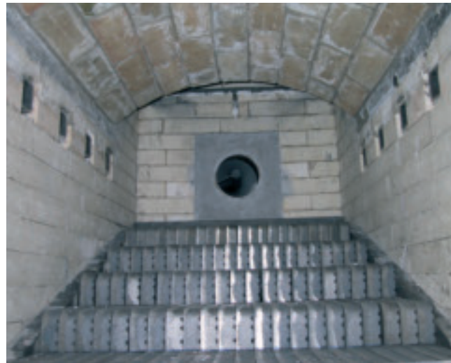
Foto 4.3. La griglia mobile all'interno della camera di combustione. Fonte: UNICONFORT Srl.
