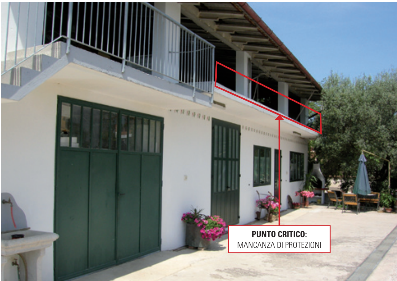
Figura 45. Mancanza di protezioni, le porte e le aree cerchiate, danno sul vuoto
