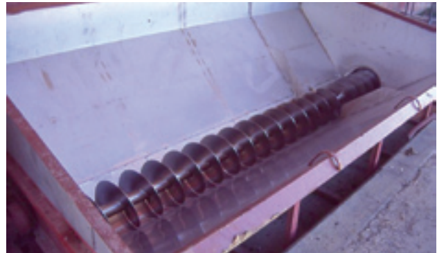
Figura 47. Punto critico per vasca di conferimento non a norma
