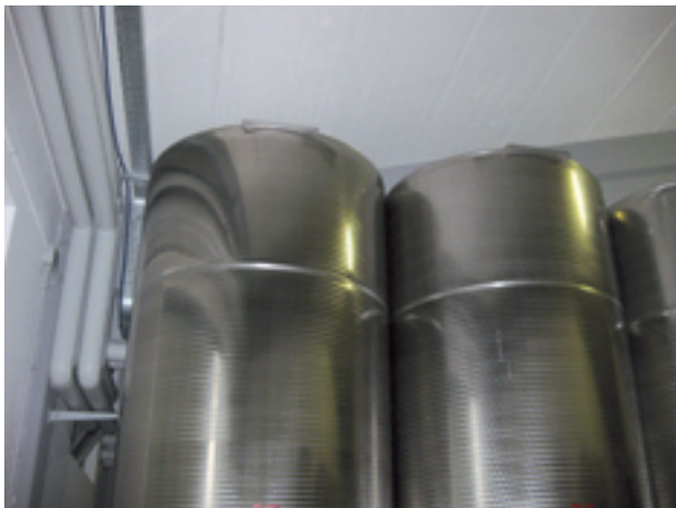
Figura 55. Vasi radenti al soffitto, in questa condizione per l'operatore aumentano le possibilità di caduta, non essendo possibile operare facilmente per limiti fisici
