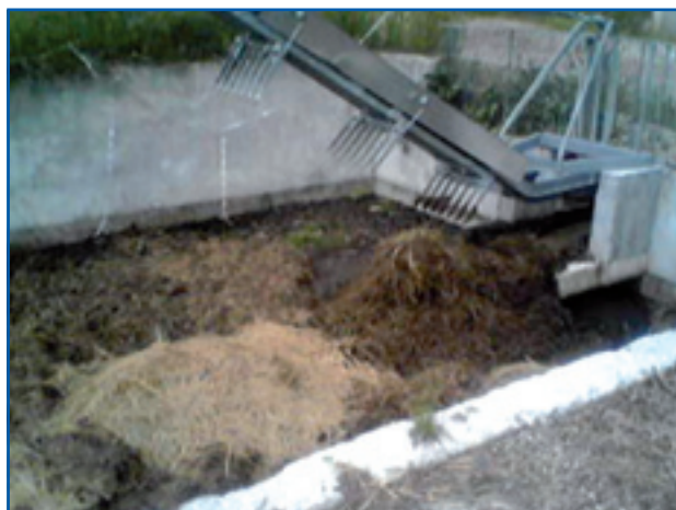
Figura 69. Mancanza di protezioni nella zona di stoccaggio del letame
