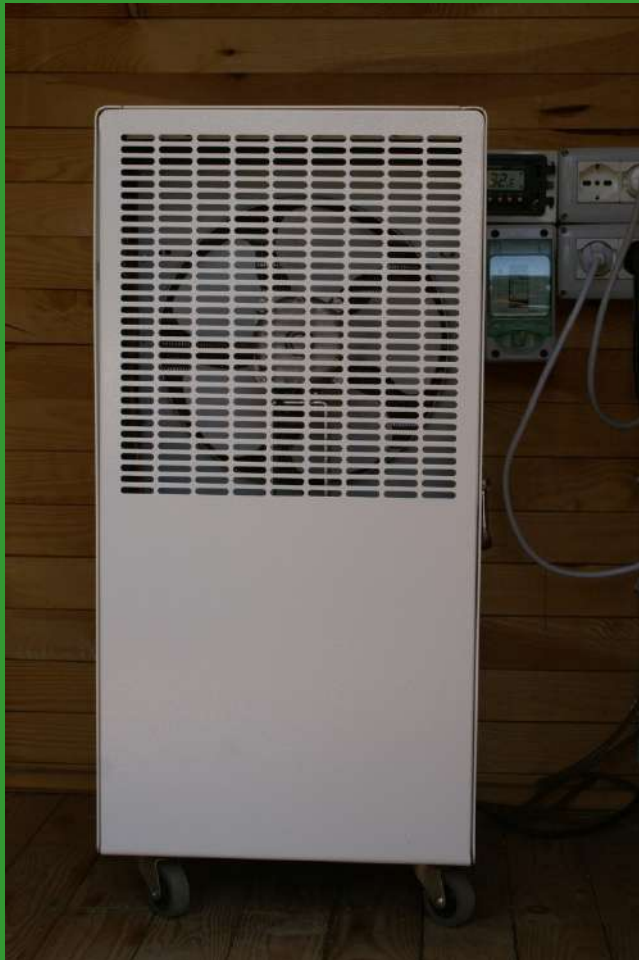
Figura 2: Deumidificatore e Impianto Elettrico con rilevatore di temperatura a dx.
