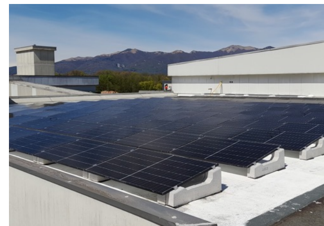
2: vista impianto, tetto piano
